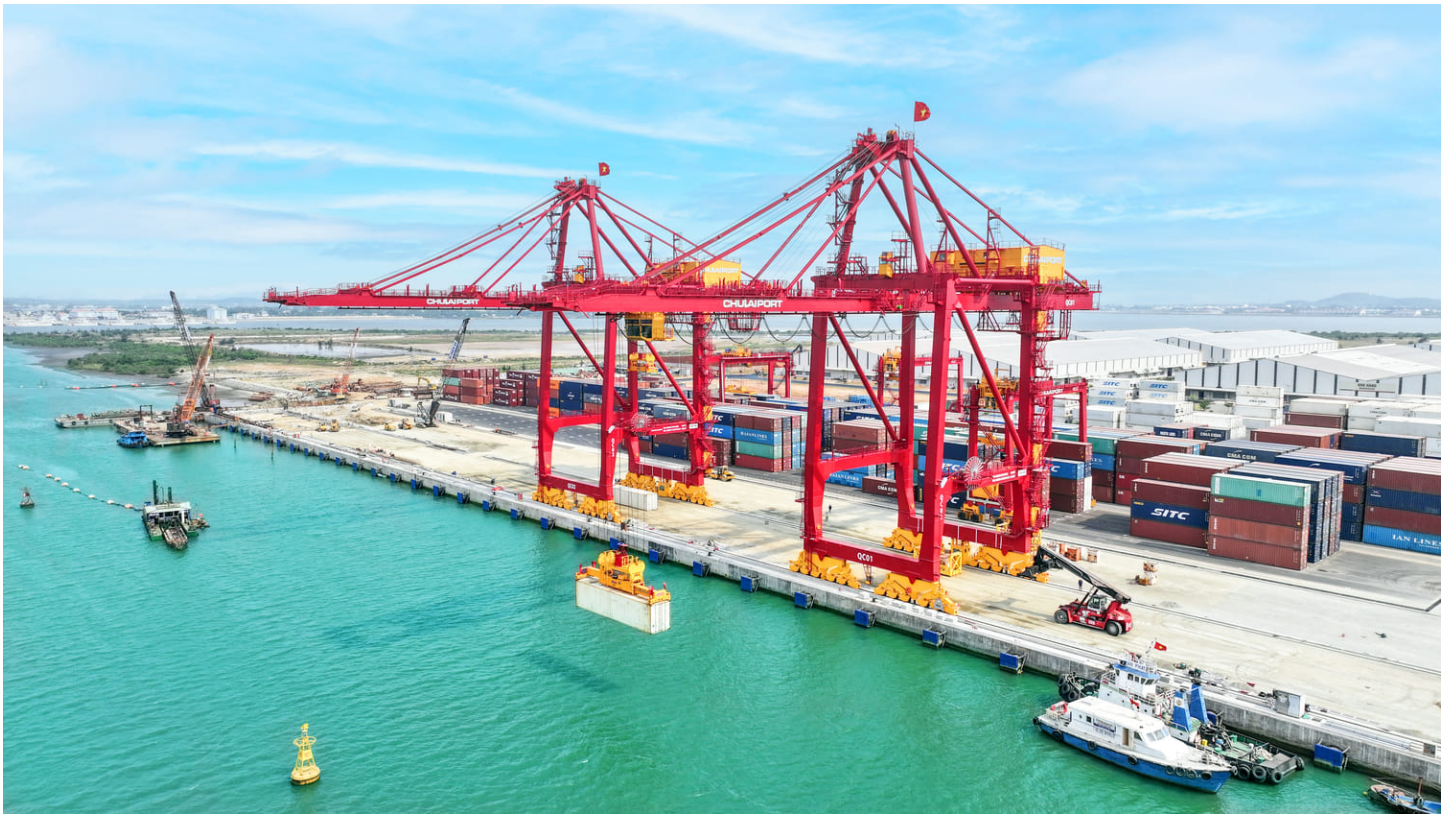
Hình 5: 2 cầu trục STS chạy trên đường ray và 3 cầu eRTG xếp dỡ khu vực bãi container với tổng giá trị hơn 400 tỷ đồng.
