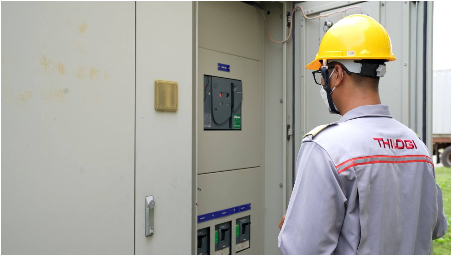
Kiểm tra hệ thống điện
