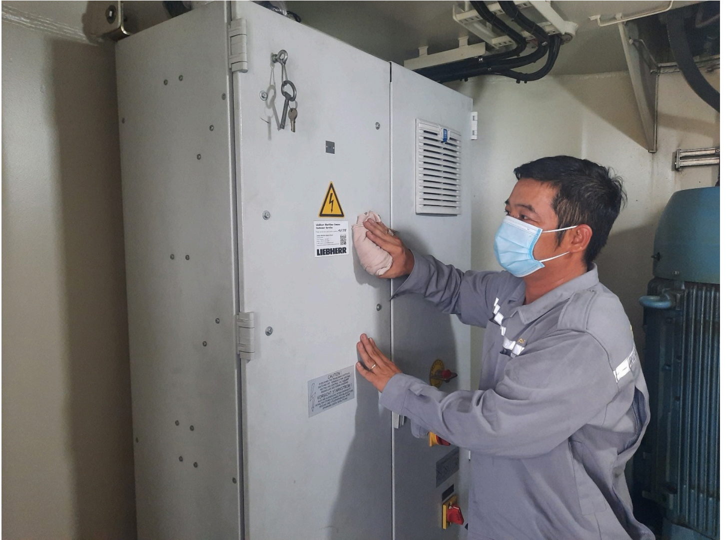
Anh Lê Duy Trinh đang vệ sinh tủ điều khiển cầu Liebherr
